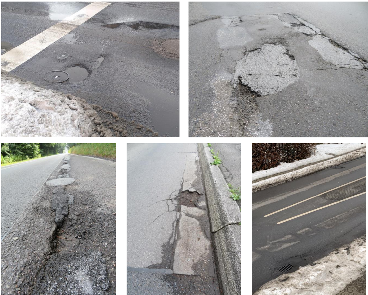
Abbildung 4: Sanierungsbedürftige Straßen in Rösrath, ein Einblick Quelle: Stadt Rösrath
