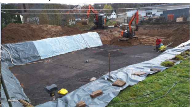
Abb. 6: ausgedehnte Baugrube für Haus 1, 208B („Sülzperle“) Grube wird lfd. abgepumpt; für Tiefgarage vorgesehen? Der Baukörper bedeutet erhebliche Versiegelung sowie Verringerung pot. Retentionsflächen, dazu kommen wohl Aufschüttungen zur Sülz hin.
