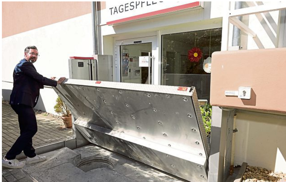
Vor der Tagespflege des Wöllner-Stifts zeigt Geschäftsführer Michael Heine, wie eine Edelstahl-Wand im Fall von Hochwasser automatisch hochgefahren wird. Fotos: Christopher Arlinghaus
